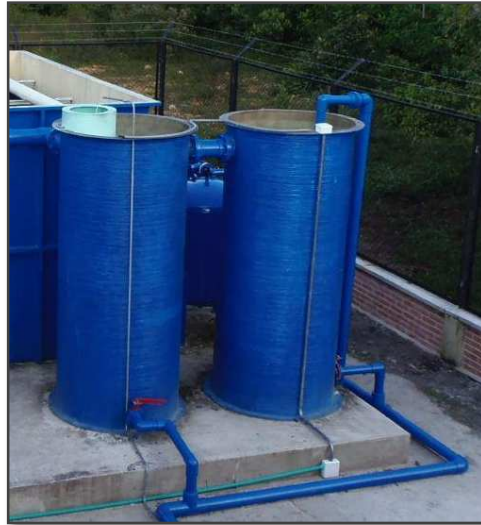
Imagen 11: Tanque de desinfección
