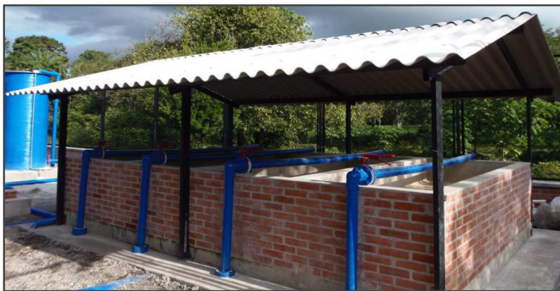
Imagen 15: Lechos de secado de lodos
