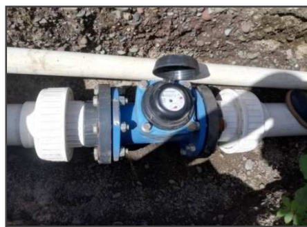
Imagen 17: Medidor de agua
