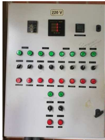
Imagen 18: Tablero de control
