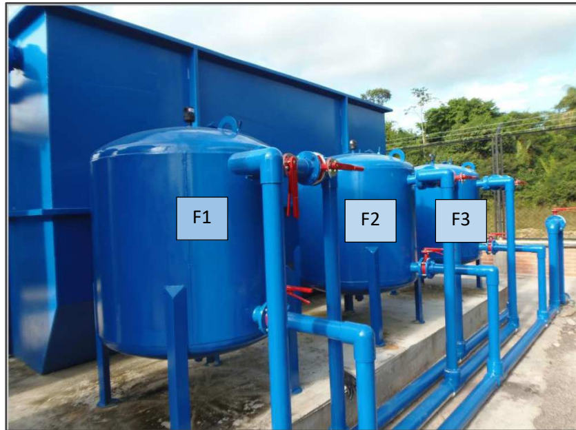
Imagen 13: Sistema de filtración
